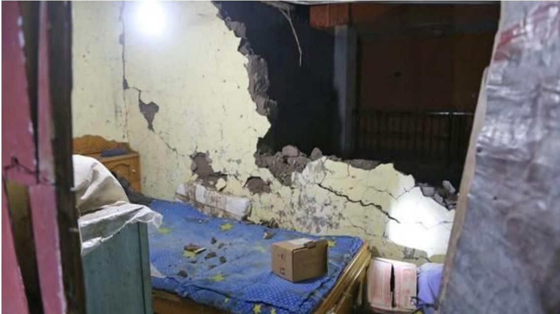
El interior de una vivienda dañada por el sismo ocurrido en la región Arequipa, en el sur de Perú./ EFE
